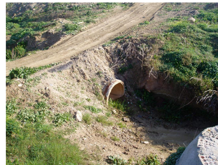
F1 Tubo aguas abajo
